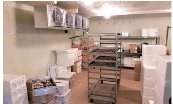
新しくした冷凍設備
