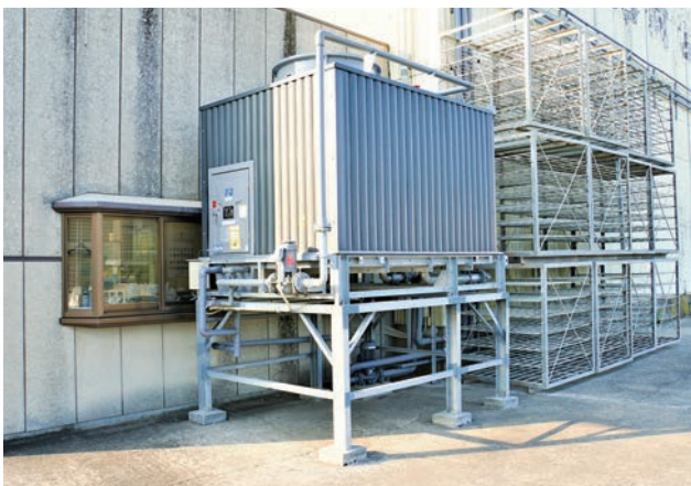
これまで冷却水として使用していた井戸水が出なくなったため、新しく設置したクーリングタワーが活躍している
